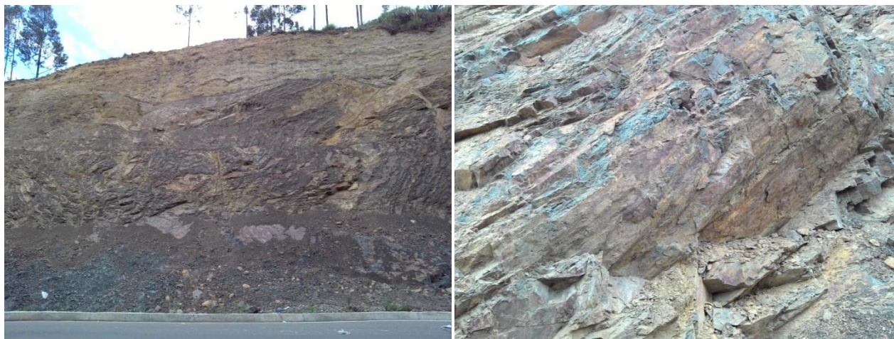
Fotos 17 y 18. Vertiente rectilínea con fuerte disección y detalle del macizo rocoso. Sector San Miguel. 07/04/2014.
