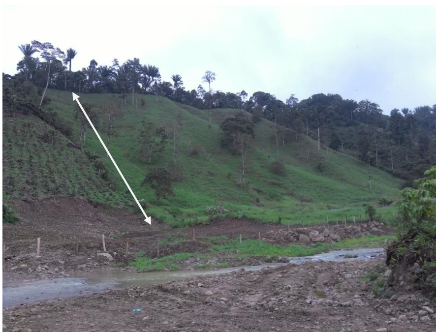
Foto 7. Abrupto de cono de esparcimiento. Sector Campoverde. 21/10/2014.
