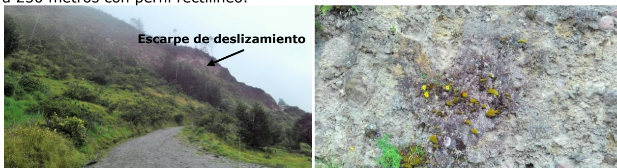
Fotos 27 y 28. Escarpe de deslizamiento. Vista general y detalle del macizo rocoso en aglomerado de la Fm. Pisayambo. Sector Lindero Loma. 05/11/2014.
