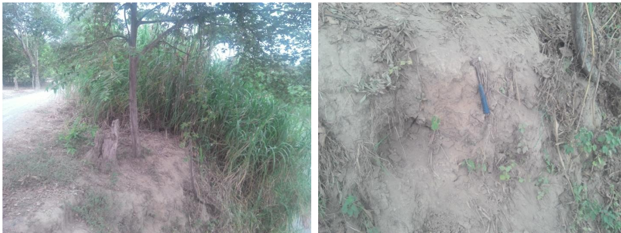
Fotos 5 y 6. Dique o banco aluvial. Vista general y detalle del depósito: bloque angular, grava, arena, limo y arcilla 5%. Sector San José de la Tranca. 22/10/2014.
